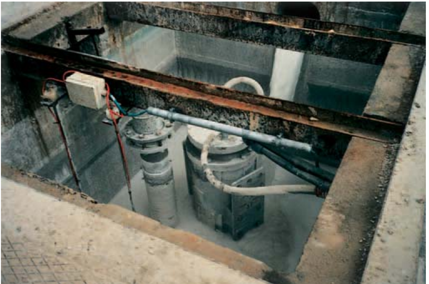
Pompaggio polveri di marmo da vasche di raccolta Pumping marble dust from a sump
